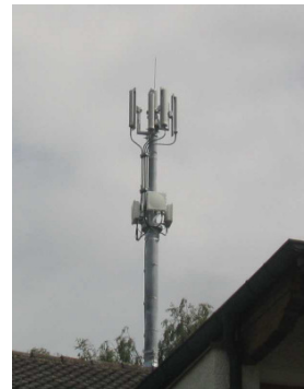
WiMAX-Station mit Sektorantennen
